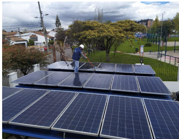
Ilustración 3 Imagen de mantenimiento Paneles Solares
